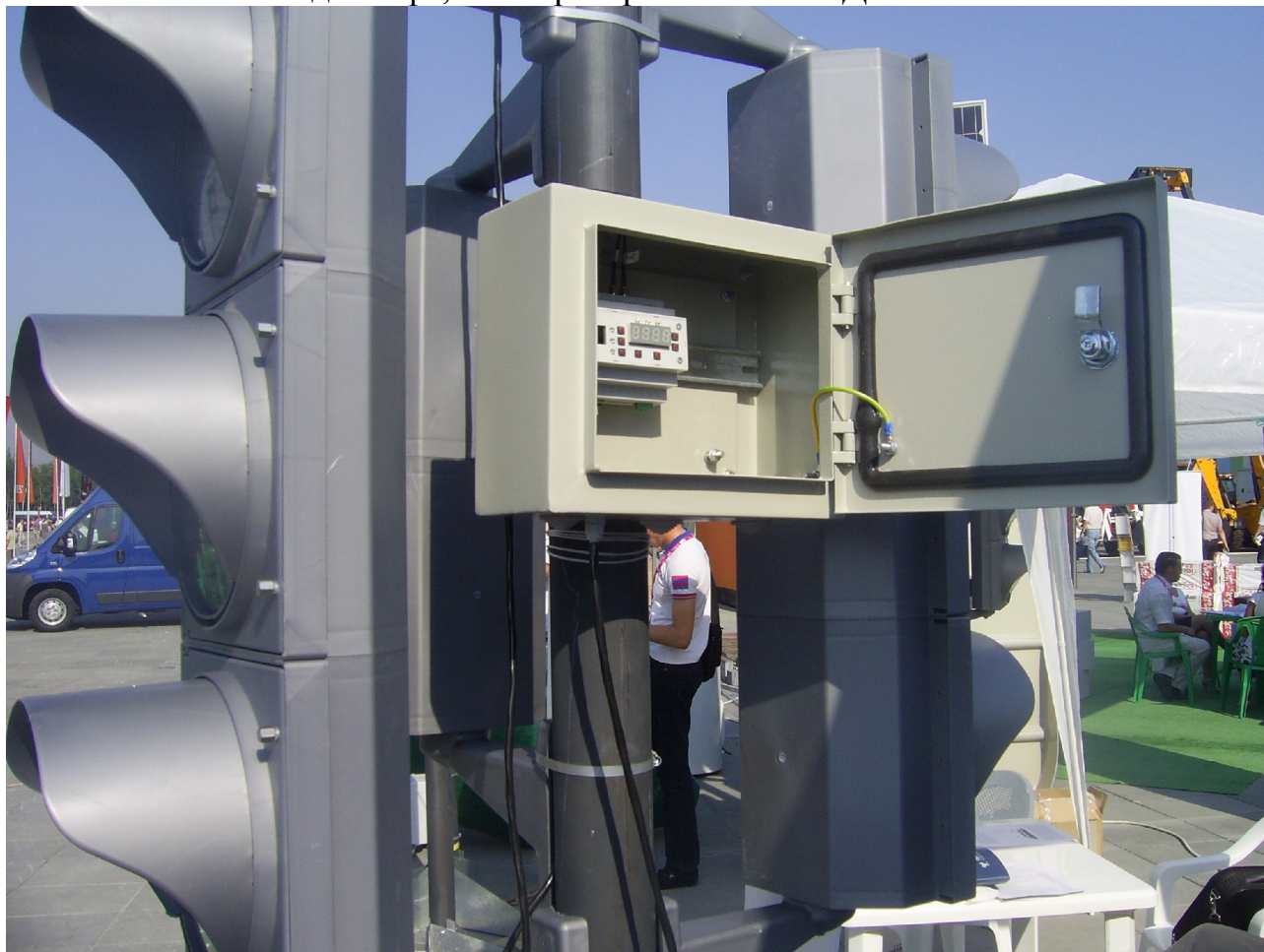
Внешний вид шкафа, в котором расположен КДА-2.
